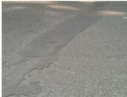
Gambar II.5 Contoh Jenis Kerusakan Distorsi
