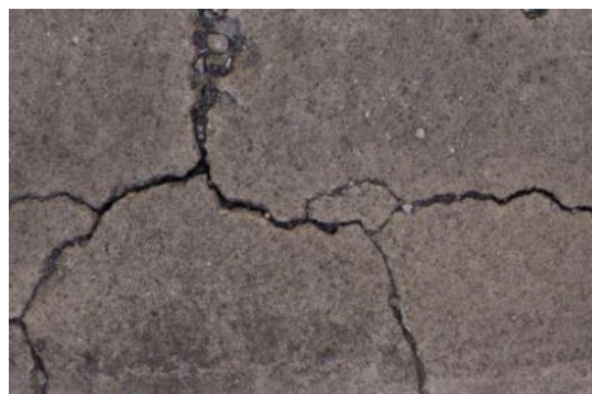
Gambar II.4 Contoh Jenis Kerusakan Retak
