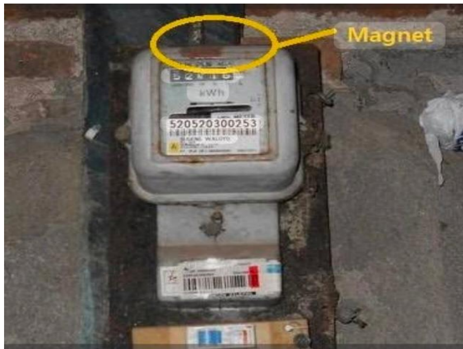
Gambar II. 2 Meteran Listrik yang ada Penghambatnya
